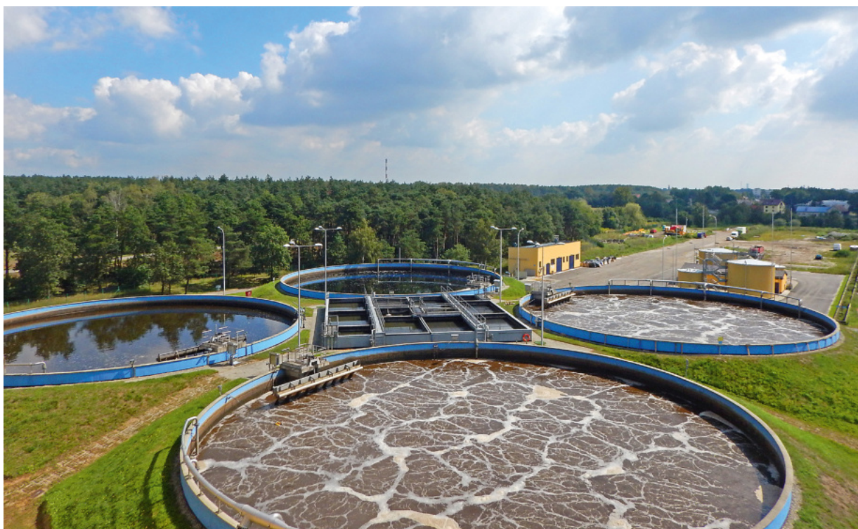
Zdjęcie 1. Zmodernizowana część biologiczna oczyszczalni – komory sekwencyjne technologii C-TECH
