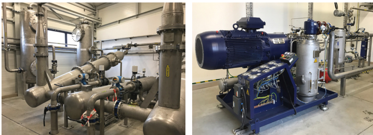
Zdjęcie 4. Instalacja Stacji Oczyszczania Biogazu z dwutlenku węgla
