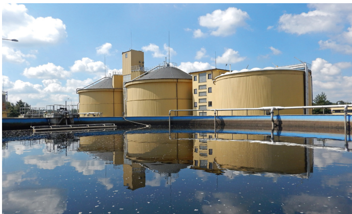
Zdjęcie 2. Komory fermentacyjne (2 x 5500 m 3 )
